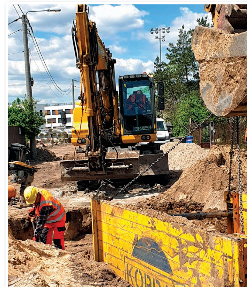
Prace w toku. Budowa kanalizacji deszczowej w ulicy Marsa. Dzięki podziemnej infrastrukturze wody opadowe i roztopowe zasilą zbiornik Konne.
